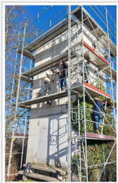
Zufällig war das Trafohäuschen im Februar eingestüst, das waren ideale Bedingungen für die Nistkastenpflege
